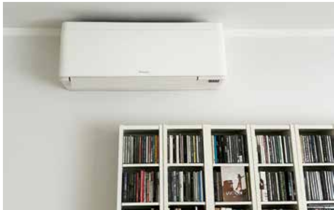
Klimaanlagen: Sie sorgen im Sommer nicht nur für angenehme Kühlung, sondern können Wohnräume in der grauen Jahreszeit ebenso energieeffizient beheizen.
