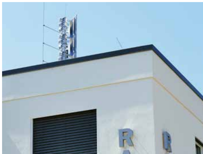
Auf dem Dach des Belmer Rathauses ist eine von insgesamt fünf neuen Sirenen installiert. Foto: Gemeinde Belm/D. Meyer
