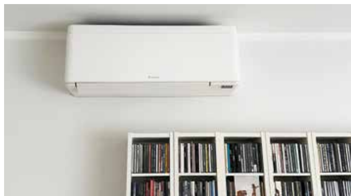
Klimaanlagen: Sie sorgen im Sommer nicht nur für angenehme Kühlung, sondern können Wohnräume in der grauen Jahreszeit ebenso energieeffizient beheizen. Foto: Gering Kälte Klima
