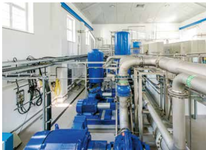
Die Trinkwasseraufbereitung im Wasserwerk Düstrup kann im Rahmen der Stadtwerke-Besucherführungen besichtigt werden.
