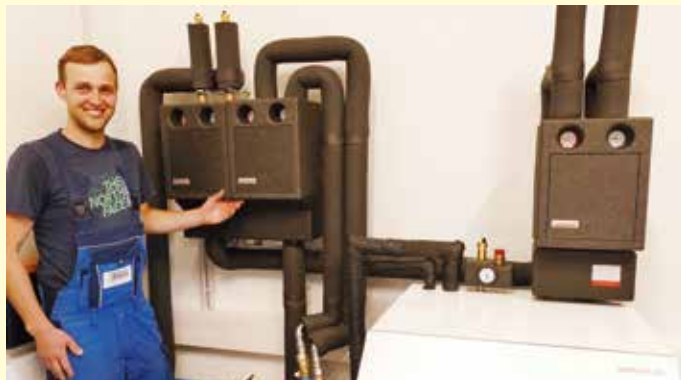
Technikraum für die Wärmepumpe: Sowohl das Firmenbüro im ehemaligen Gülle-Silo mit Fußbodenheizung wie auch das private Wohnhaus von Theo-Wilm Rüters auf dem Firmengelände werden von einer Wärmepumpe versorgt. Der Belmer Heizungs- und Sanitärbetrieb setzt auch bei der eigenen Energieversorgung auf Klimaschutz und Innovation.
